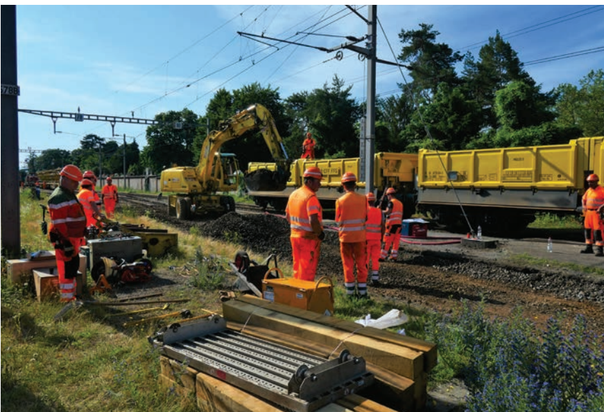
Gut geplant, gut abgesprochen, gut begleitet. Der Austausch mehrerer Geleise samt Unterbau im Wolf-Bahnhof hinterliess kaum Spuren im umgebenen «Bewuchs».
